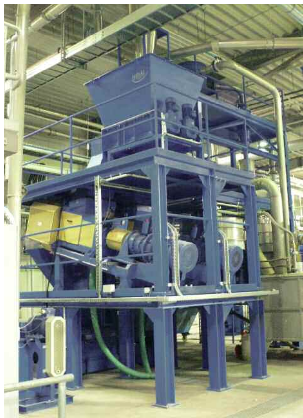
Zwei EPS 75 mit Verteilerbunker
