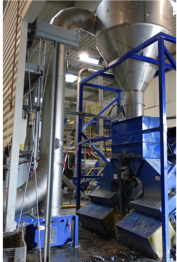
Fig.3: Tubo ascendente con conducto de descarga y ciclón para la descarga de material en un separador balístico.
