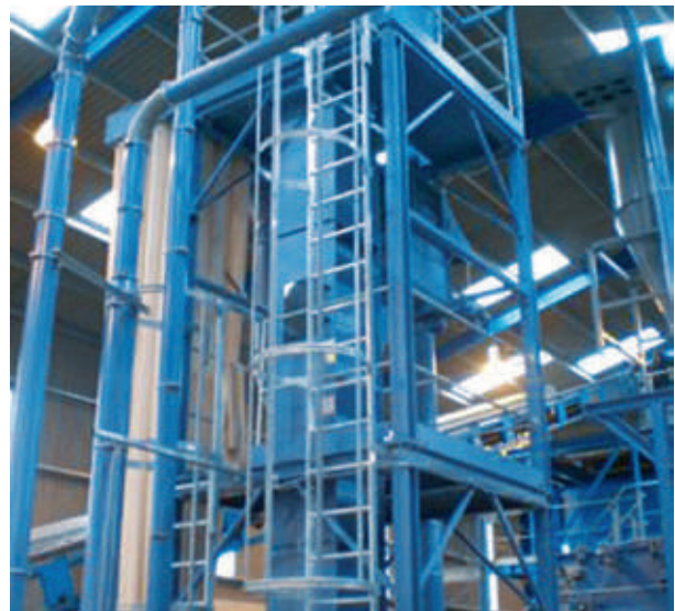
Abb. 2: Schwerkraftsichter mit Wartungsbühne
