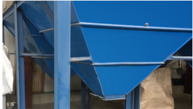
Vier werkseitig vorhandene Silos werden mit einer manuell verschiebbaren Förderschnecke angesteuert.
