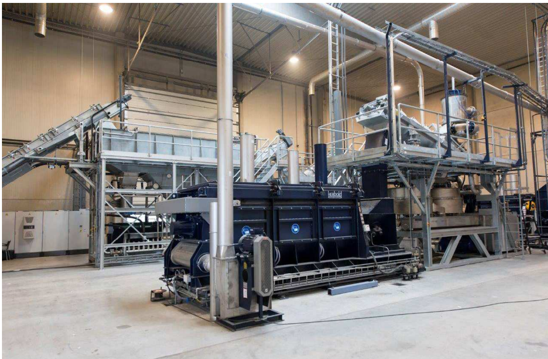
Fig. 3) Hydrocyclone + sécheur, à l'arrière-plan l'unité de pré-lavage
